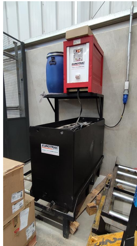
Figura 14. Área de recarga de bateria.
