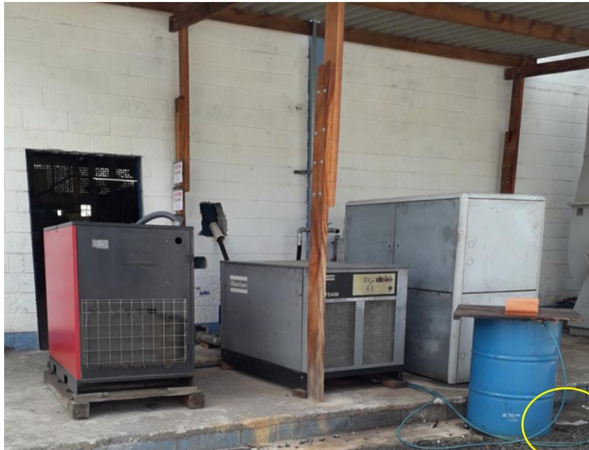
Figura 17. Área de compressores, sem estruturas de contenção e com vazamento de água de purga, em 04/12/2019.
