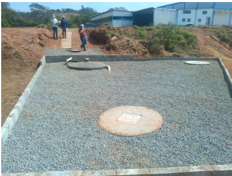
Figura 10. Novo sistema de tratamento de efluentes sanitários (biodigestor) para suporte ao sistema já instalado.
