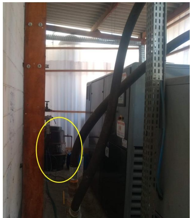
Figura 19. Área de compressores com adequação da coleta de água de purga, em 10/09/2020.
