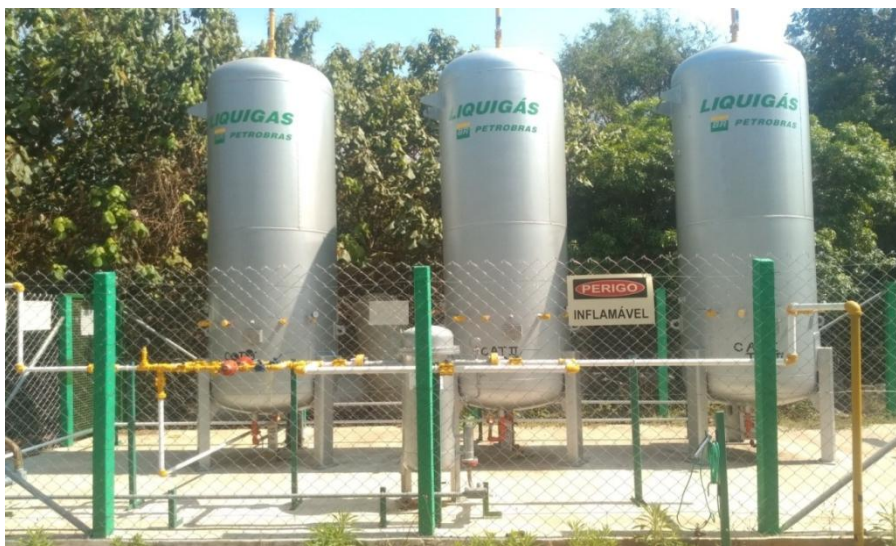
Figura 9. Central de Gás Liquefeito de Petróleo – GLP.
