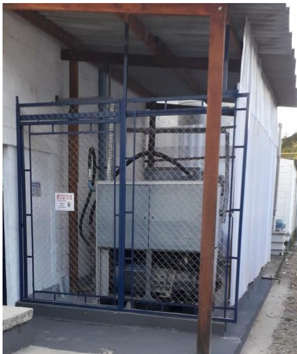
Figura 18. Área de compressores do empreendimento, com estruturas de contenção em alvenaria, em 10/09/2020.
