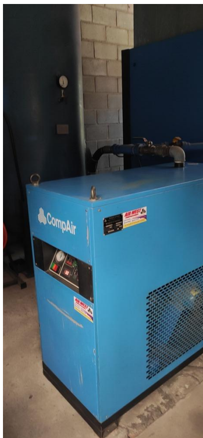
Figura 11 . Sala de compressores
