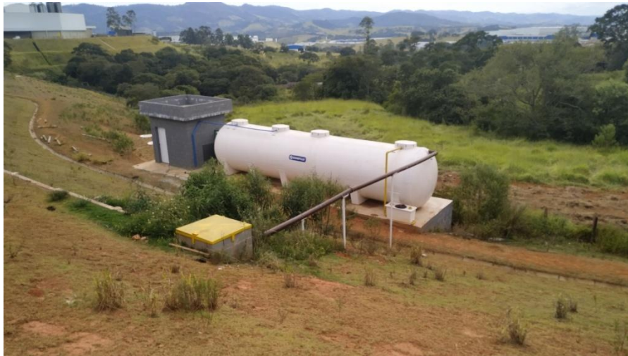
Figura 7. Estação de Tratamento de Efluentes do condomínio
