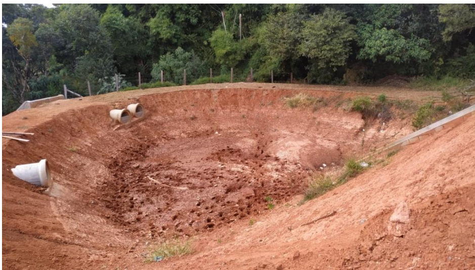
Figura 11. Tanque de contenção, localizado na porção leste do empreendimento, para captação de águas pluviais
