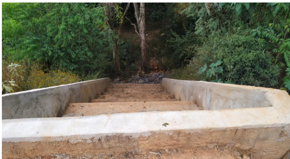
Figura 12. Escada hidráulica para lançamento do volume sobressalente da captação de águas pluviais
