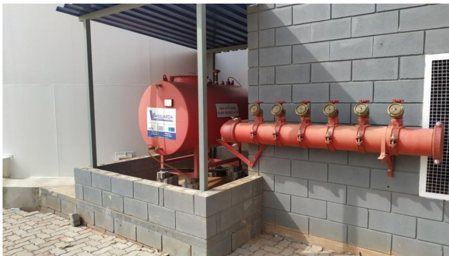
Figura 5. Reservatório de Diesel S10 utilizado no gerador do condomínio, com bacia de contenção para prevenção em caso de vazamentos.
