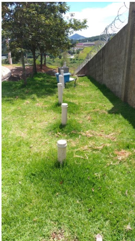
Figura 7. Vista do sistema de tratamento de efluentes do empreendimento
