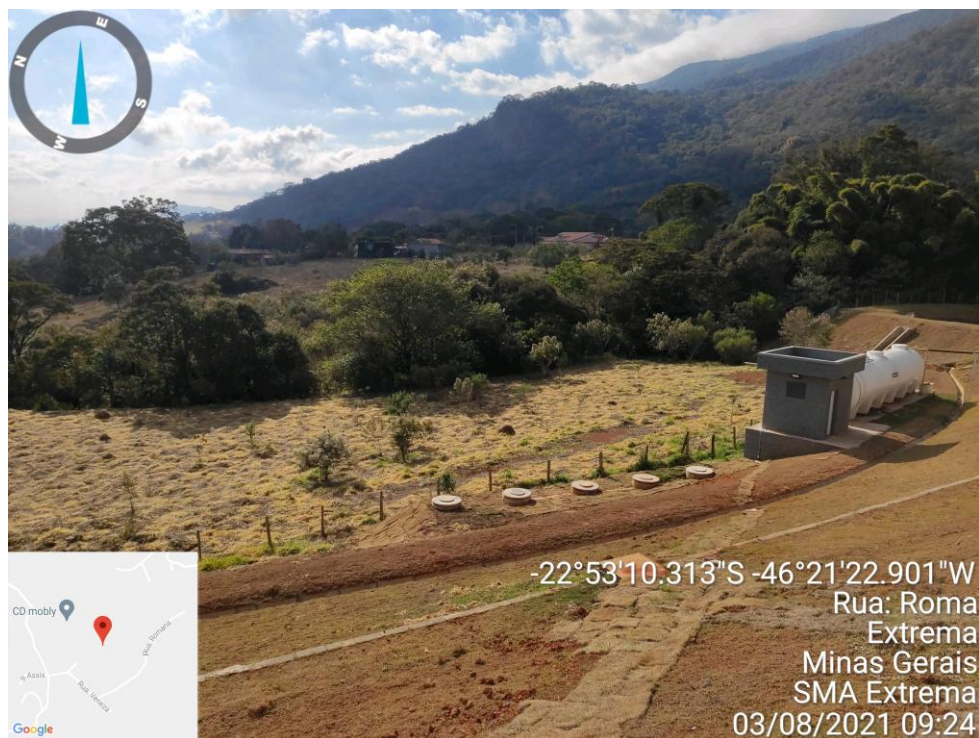
Figura 7. Estação de Tratamento de Efluentes do condomínio e Sumidouros da ETE
