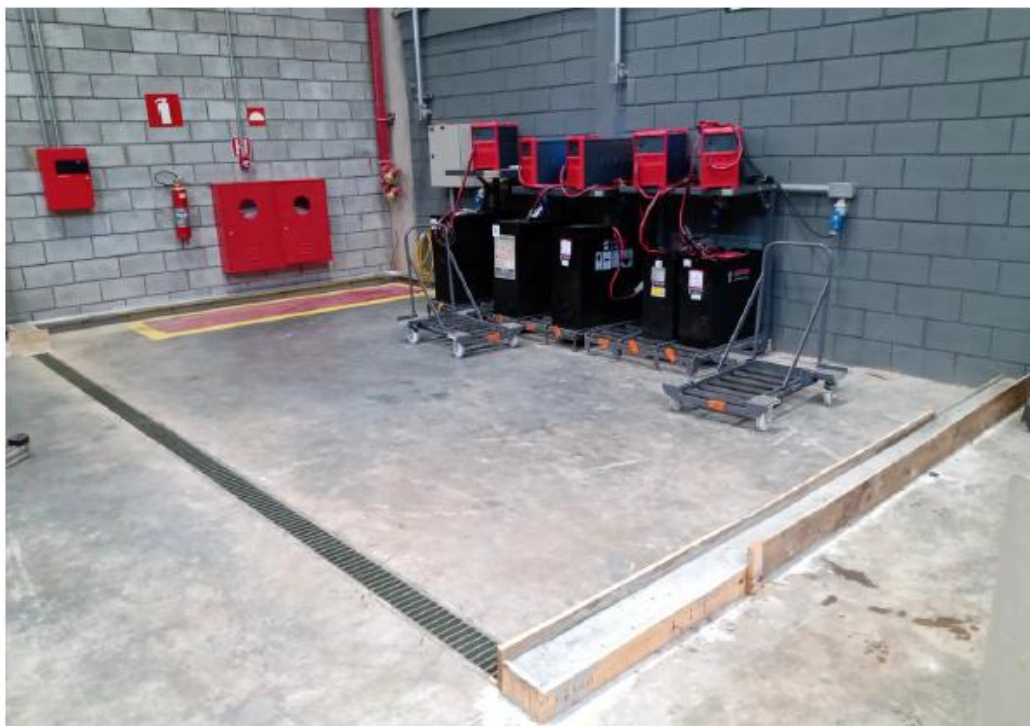
Figura 5. Área (2) de carregamento de baterias das empilhadeiras, com grelha, piso impermeável e finalização do sistema de canaletas de contenção.
