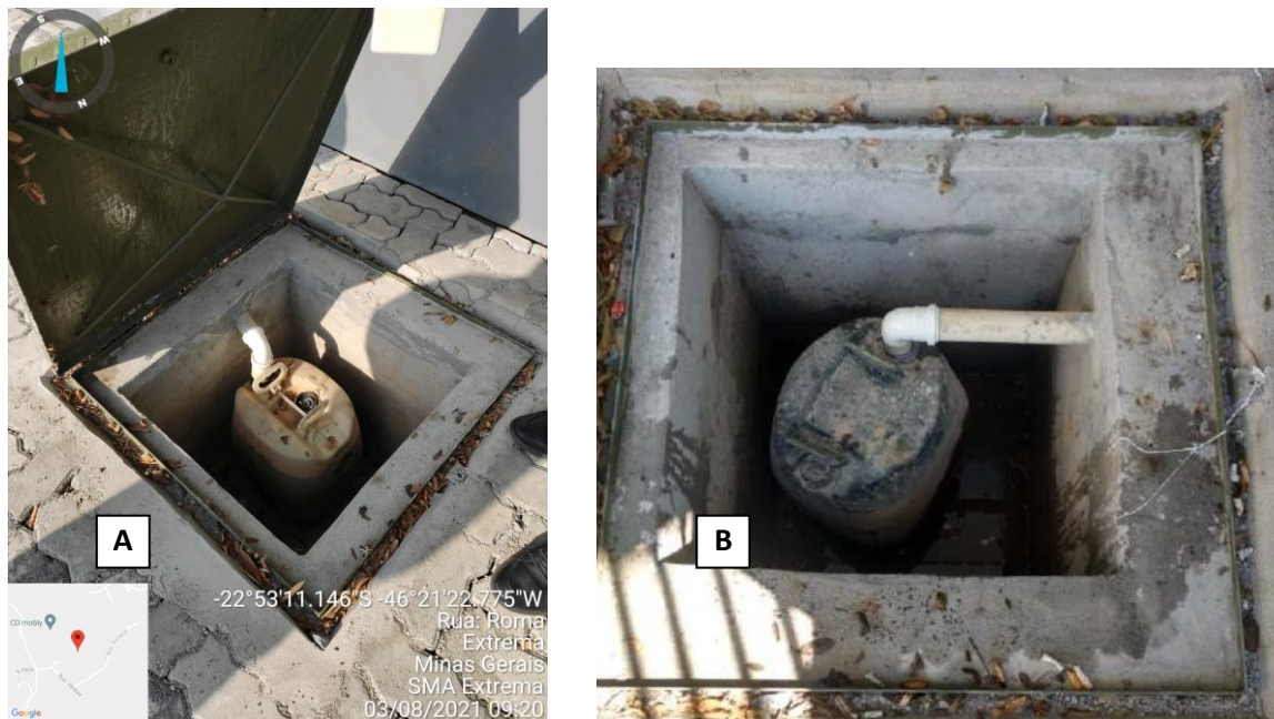
Figura 6. (A) e (B) Caixas de contenção com suporte para bombona plástica para armazenamento temporário de efluentes.
