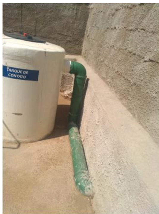
Figura 11. Saída do Efluente tratado para galeria de águas pluviais
