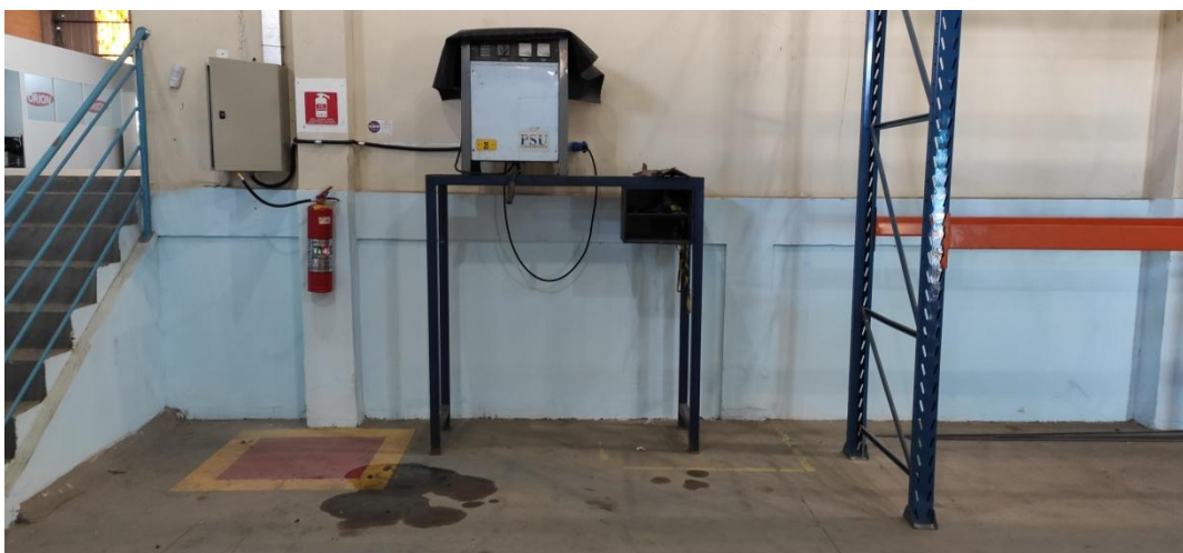
Figura 7. Área de recarga de bateria.
