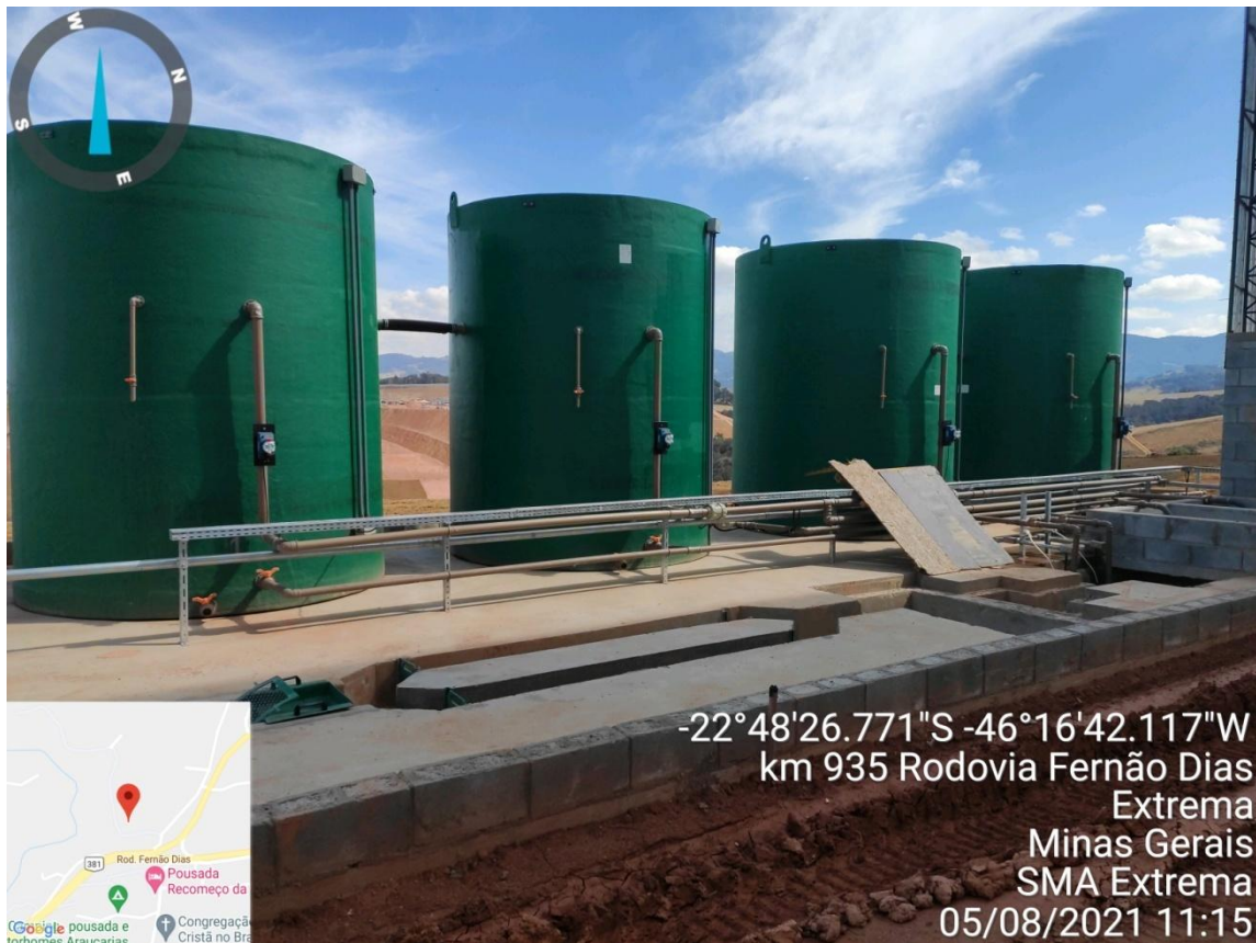
Figura 14. Sistema de Tratamento de efluentes do galpão.
