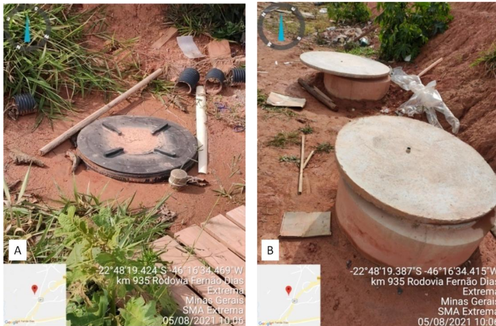
Figura 6. Sistema de tratamento de efluentes (A) e sumidouros (B) do canteiro de obras
