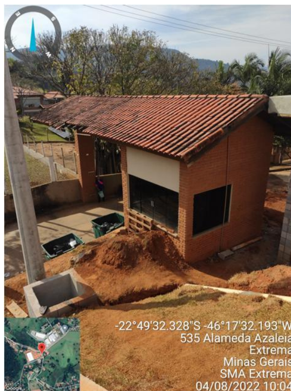
Figura 11. Sanitários do canteiro de obras (aos fundos) e caixa de passagem do sistema de drenagem de águas pluviais.
