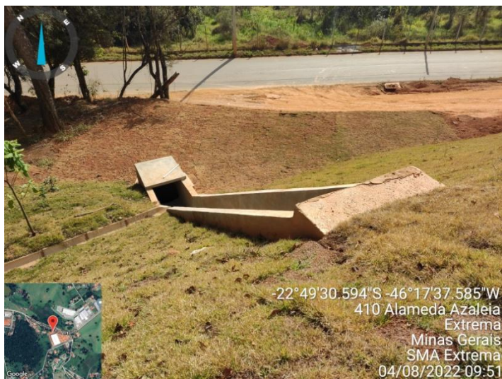
Figura 7. Escada hidráulica instalada ao noroeste do terreno do empreendimento.
