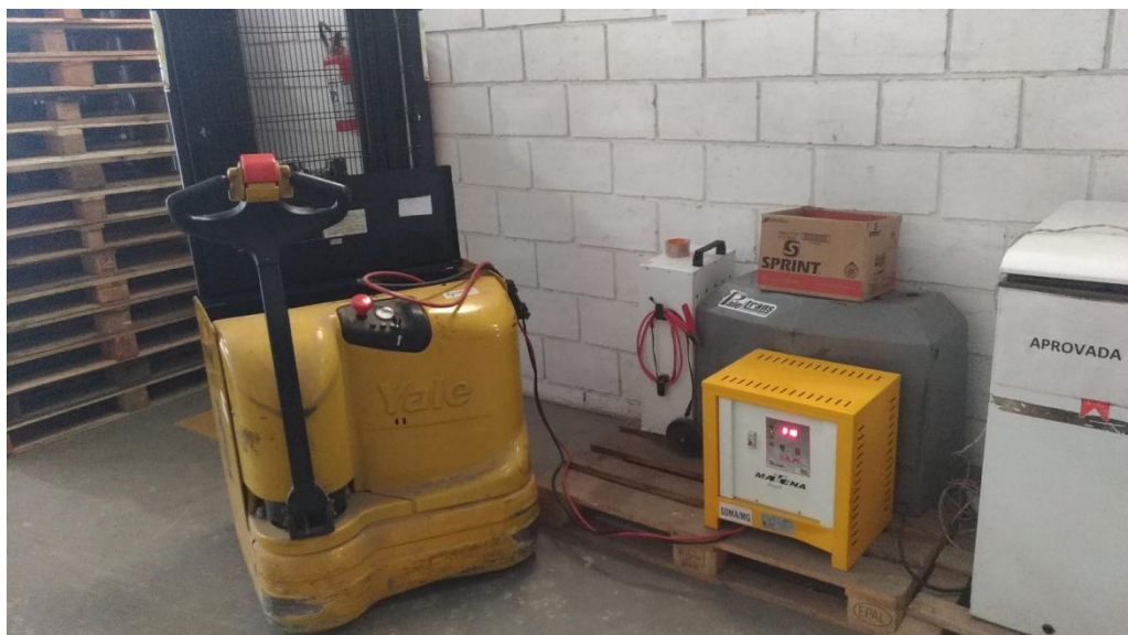
Figura 6. Local de recarga das empilhadeiras elétricas
