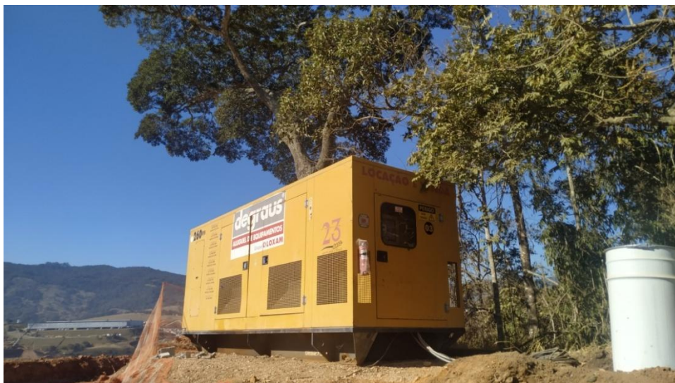
Figura 6. Gerador de energia a diesel.
