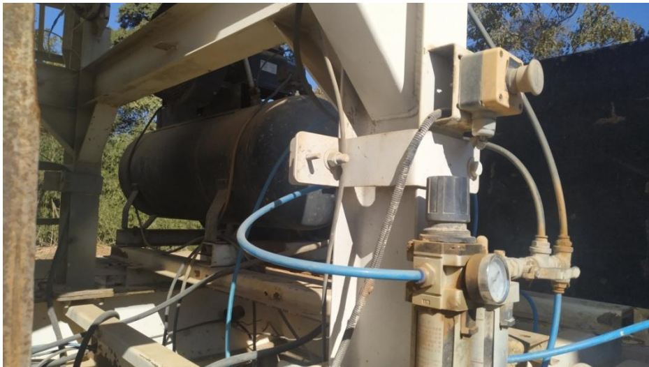
Figura 5. Compressor utilizado para suporte à movimentação de matérias-primas nos caminhões
