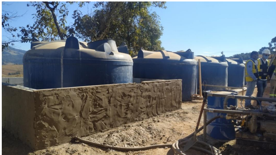
Figura 3. Vista do tanque de aditivos e tanque de armazenamento de água
