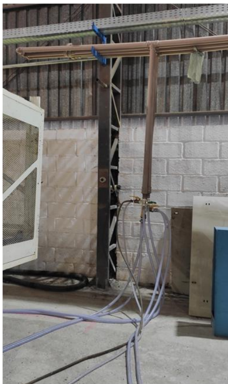
Figura 7 . Sistema de resfriamento das máquinas injetoras.
