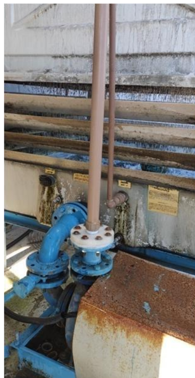
Figura 8. Torre de resfriamento.
