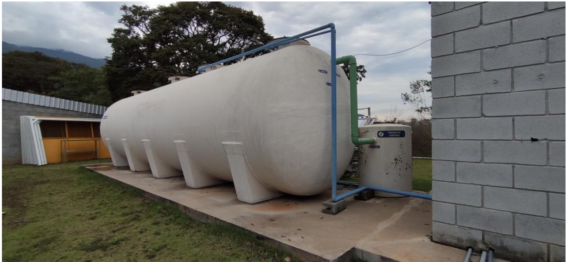
Figura 13. Estação de tratamento de efluentes sanitários.
