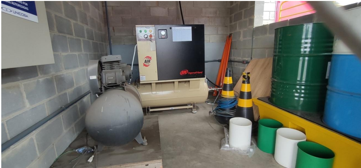
Figura 10. Área do compressor.
