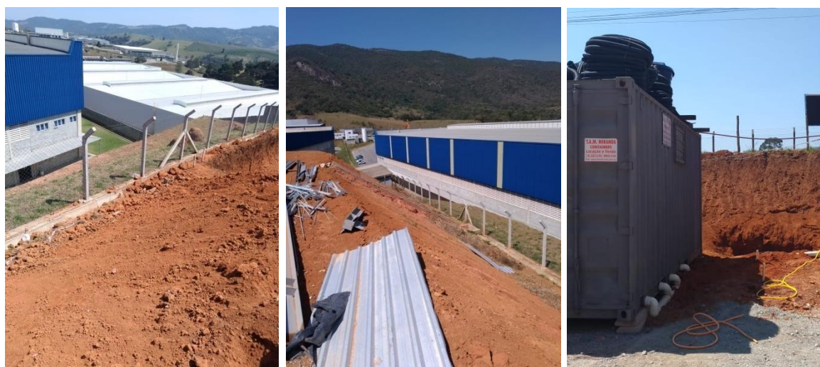
Figura 6. Talude exposto nos fundos e frente do empreendimento
