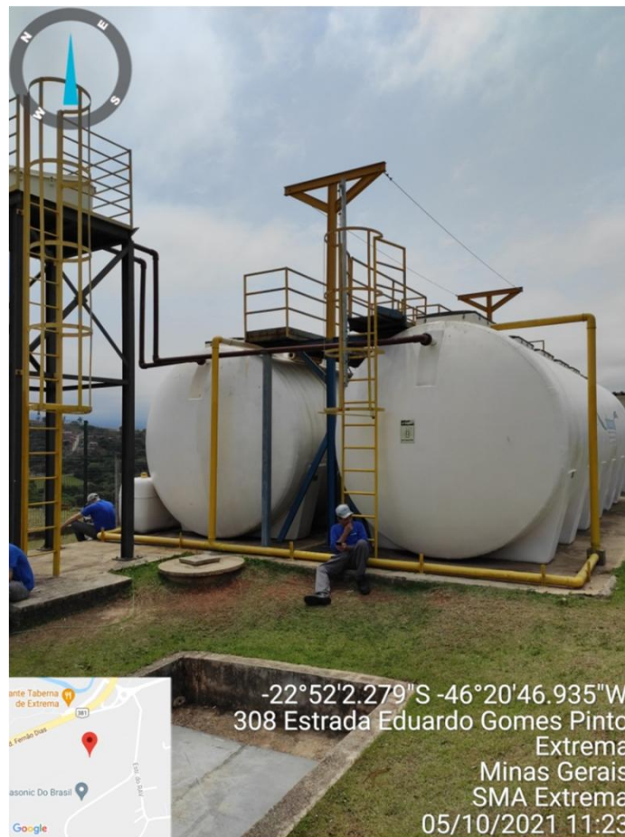
Figura 15. Atual sistema de tratamento de efluentes sanitários do empreendimento (será realocado)
