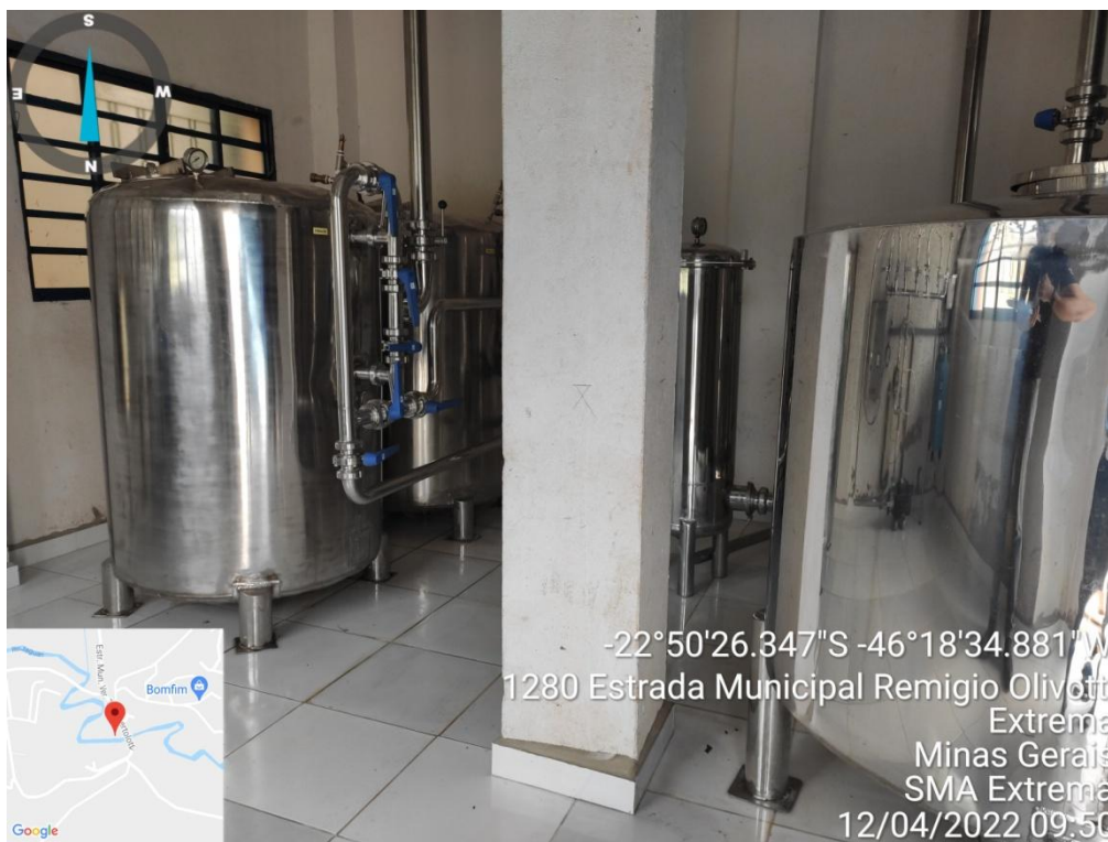
Figura 9. Sistema de filtragem da captação de água.
