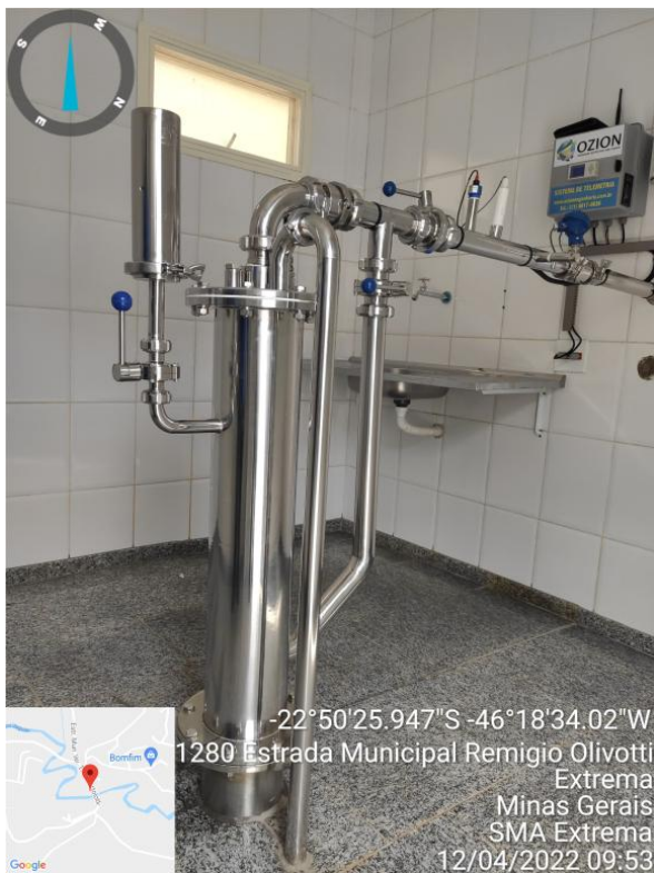
Figura 7. Sistema de captação de água.
