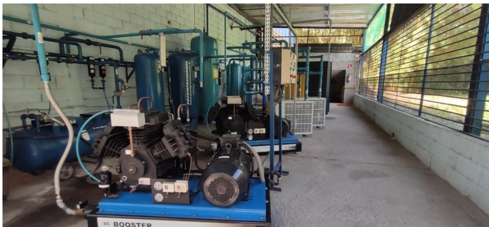
Figura 10. Área dos compressores.
