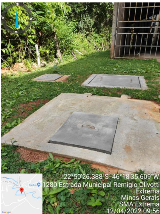
Figura 15. Sistema de Tratamento de Efluentes Sanitários (biodigestor).
