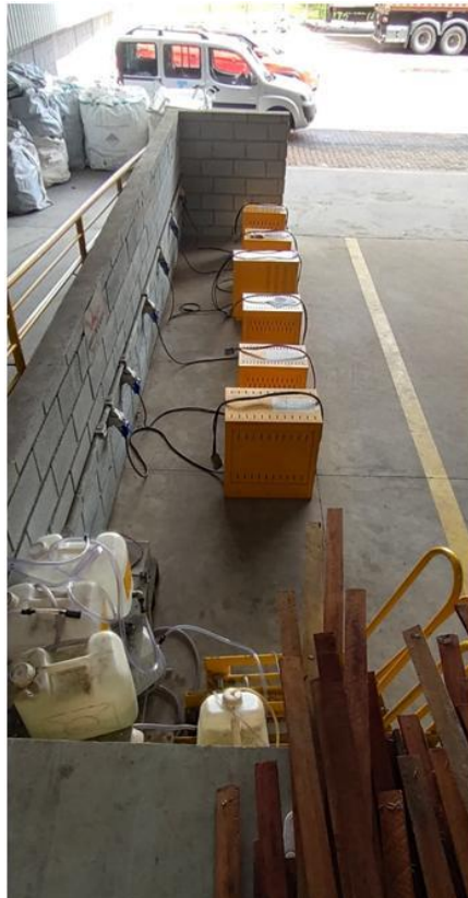
Figura 5. Central de recarregamento de empilhadeiras
