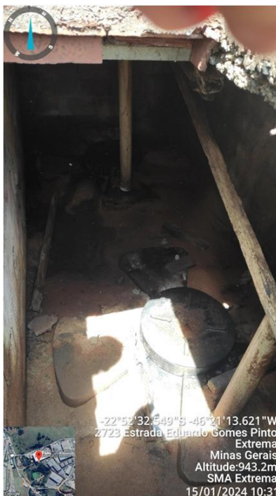
Figura 12. Fossa filtro para área galpão
