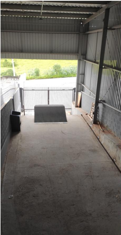
Figura 4. Doca de acesso para grandes ar-condicionados
